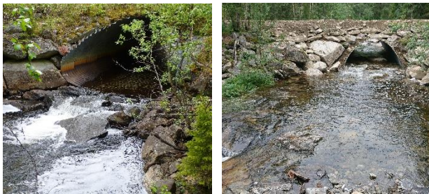
Bild 2. Byte av vandringshinderande trumma i Gäddbäcken. T.v. förebild där den fel lagda trumman hindrar öringen från att fritt vandra i bäcken. T.h. efterbild där fria vandringsvägar skapats, valvbåge med naturlig bäckbotten. Foto: Magnus Lindberg, Länsstyrelsen Västerbotten.
